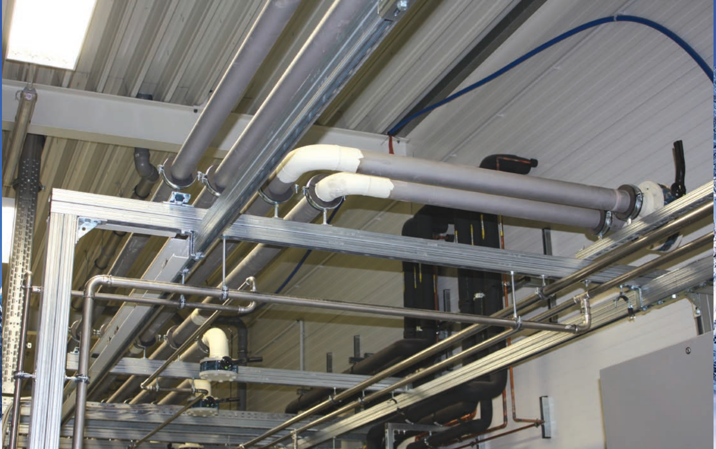
Stützkonstruktion für Kälterohrleitungen Montageschienen System 45/90 mit Kälteschelle Polar plus
