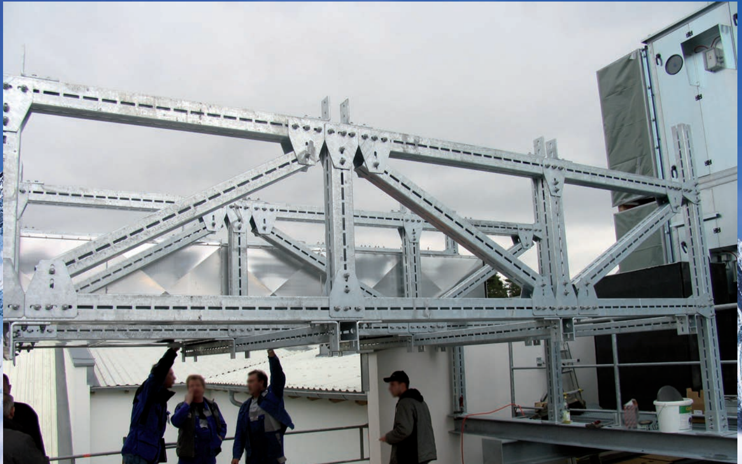
RLT-Anlage auf Dachkonstruktion CENTUM® Schwerlastsystem mit Anbauteilen
