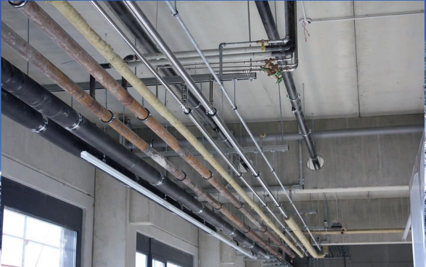
Versorgungstrasse für Produktionsanlage an Betonunterzüge Montageschienen System 45 mit Anbauteilen
