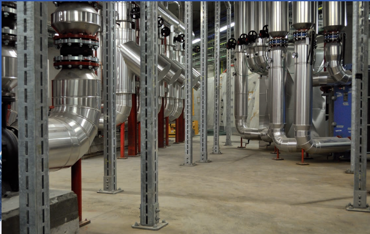
Bodenaufständerung in Heizzentrale CENTUM® Halter mit senkrechten CENTUM® XL 100 Profilen
