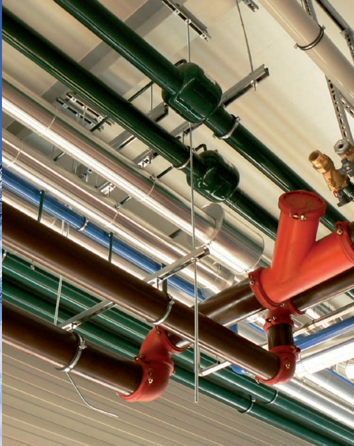
Kühlwasserleitungen CENTUM® Schwerlastsystem und 45er Schienensystem
