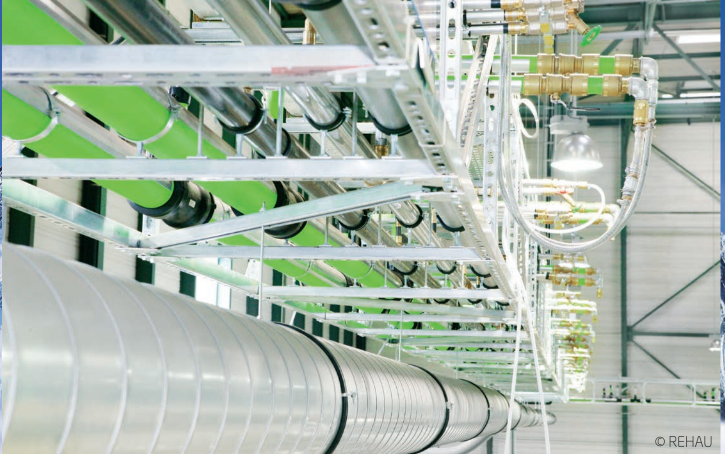
Versorgungstrasse für Produktionsanlage an Stahlträger Montageschienen System 45 mit Anbauteilen
