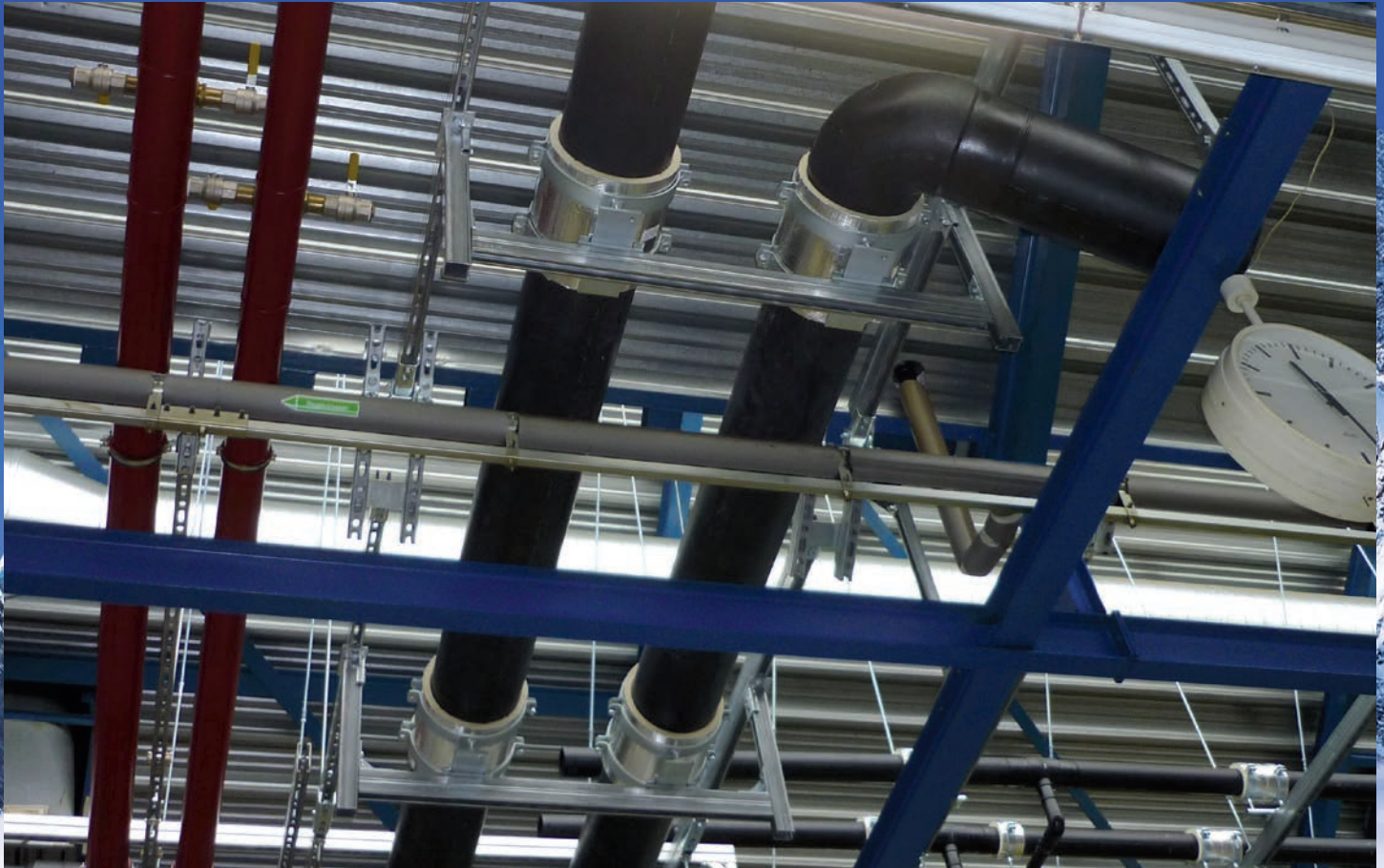
Versorgungstrasse für Produktionsanlage an Stahlträger Kälteschelle ALU/PU 80 auf Montageschienen System 45 mit Gleitplatte
