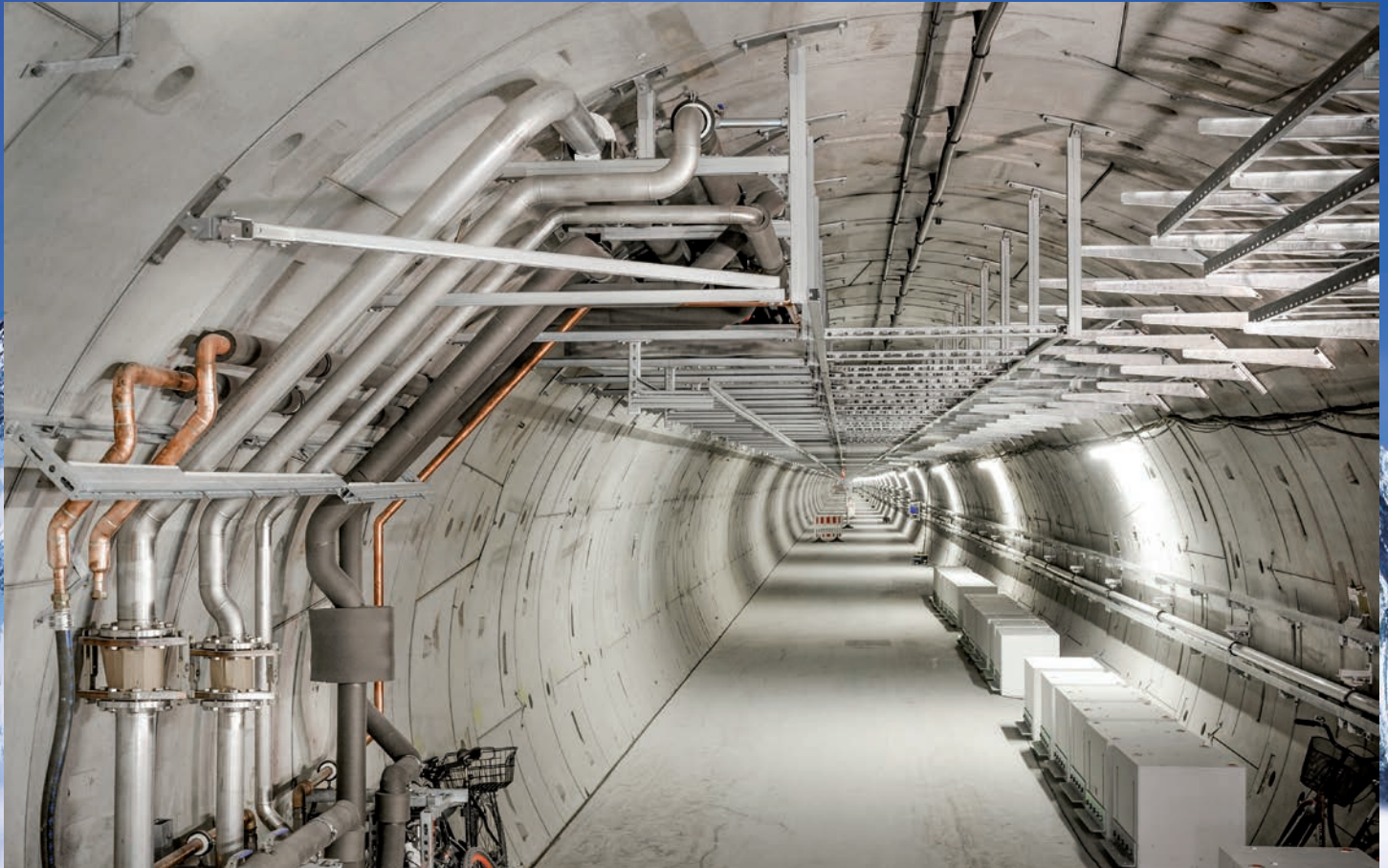
Kühlwasser- und Klimaleitungen Montageschienen System 45 mit Sondergelenkhalter
