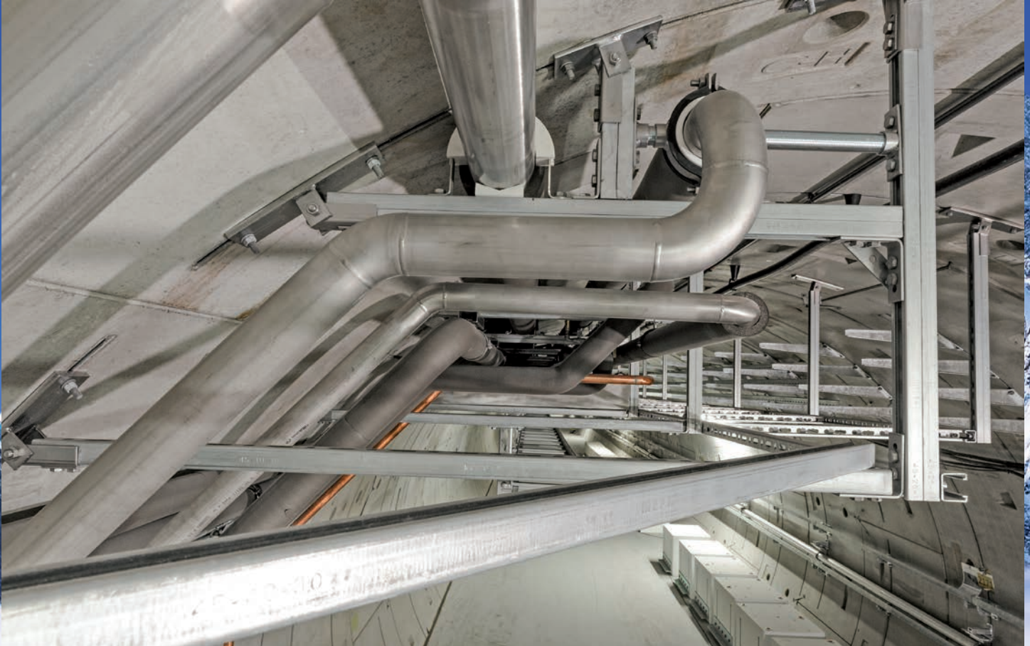
Kühlwasser- und Klimaleitungen Montageschienen System 45 mit Sondergelenkhalter
