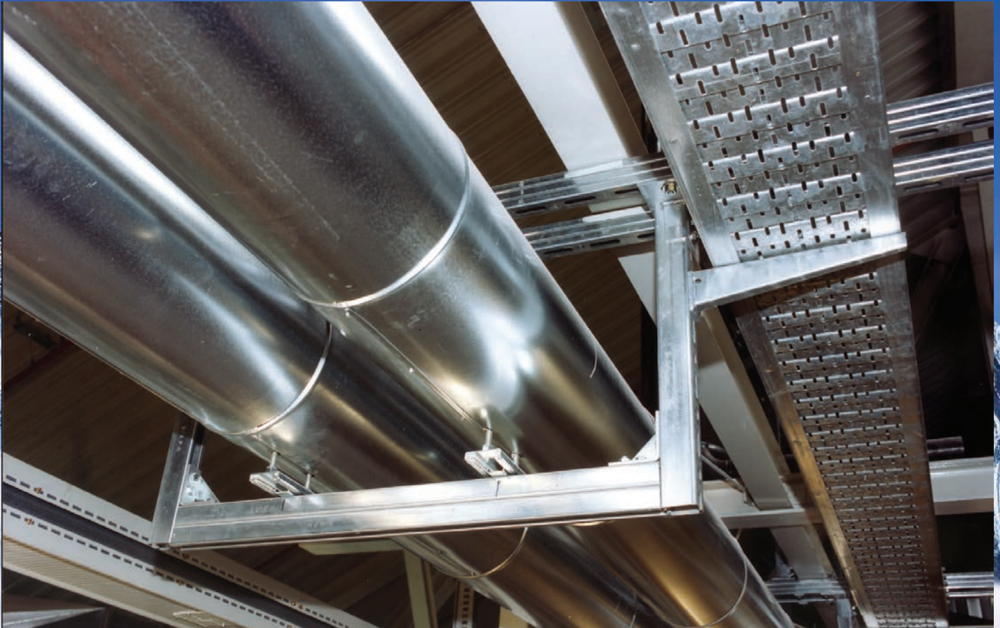
Warmgehende Leitung mit Kabeltrasse an Stahlträger Montageschienen System 45 mit Anbauteilen
